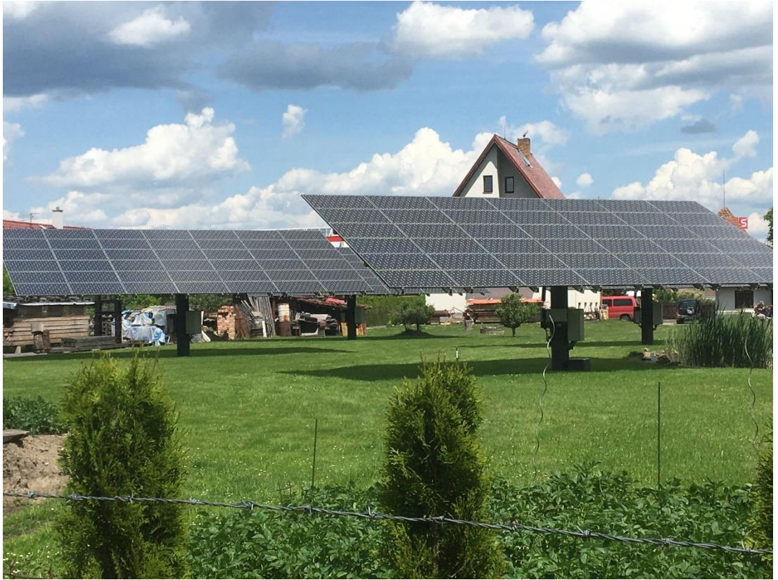
Obrázek 17 – Fotovoltaické solární panely [Foto: autor]
