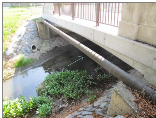
Obr. 3.13: Nadzemní potrubí ř. km 2,307
