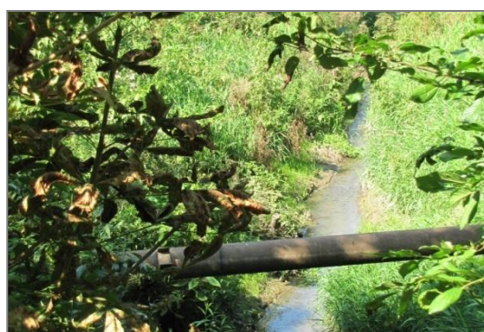
Obr. 3.29: Nadzemní potrubí ř. km 4,422
