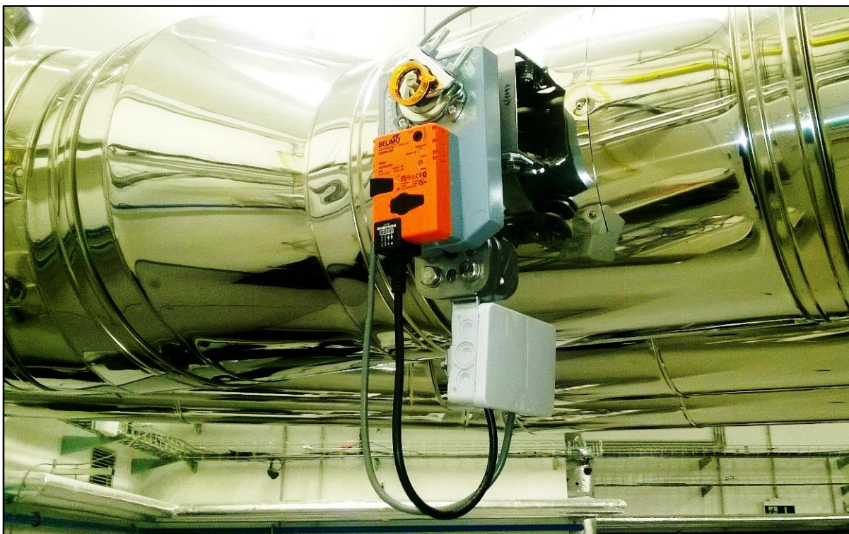
Obr. 14 Motorem řízená klapka spalin nainstalovaná na odtahu GMT C30 v LENP
