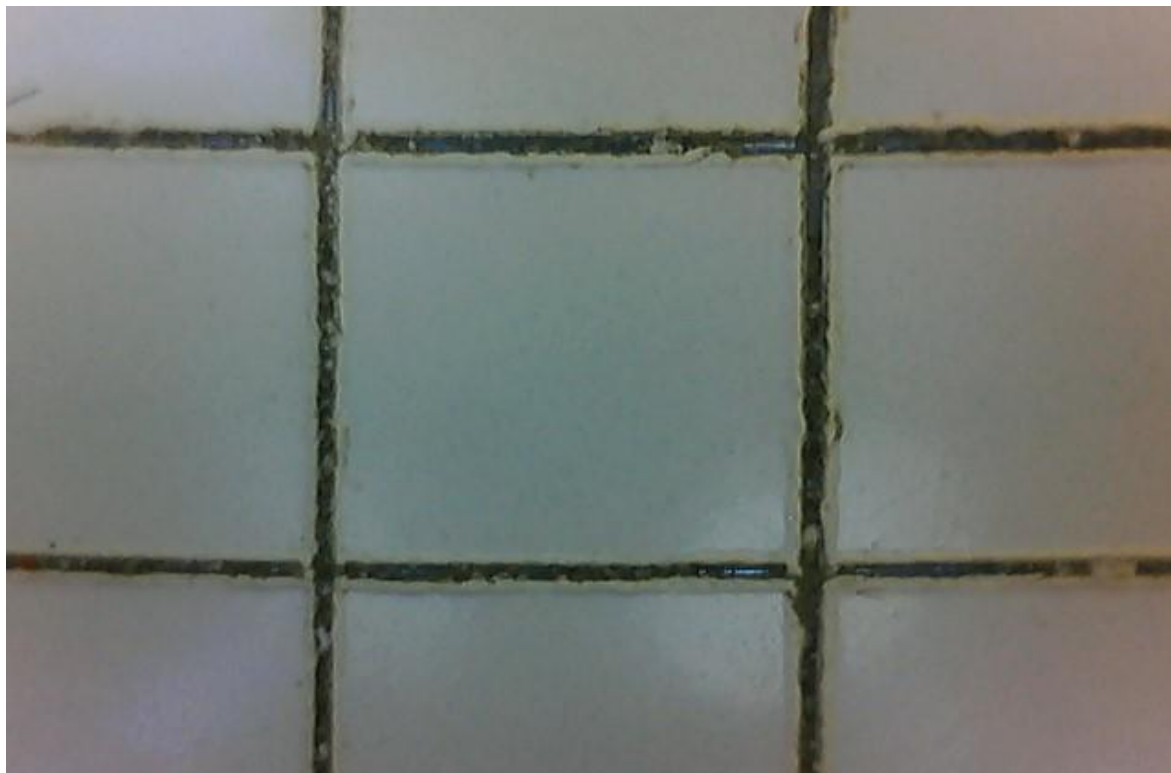
Obr. 49 Detail mřížkové zkoušky
