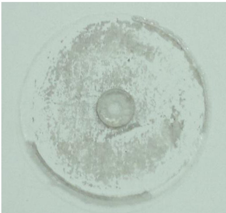
Obr. 55 Detail odtrhové zkoušky
