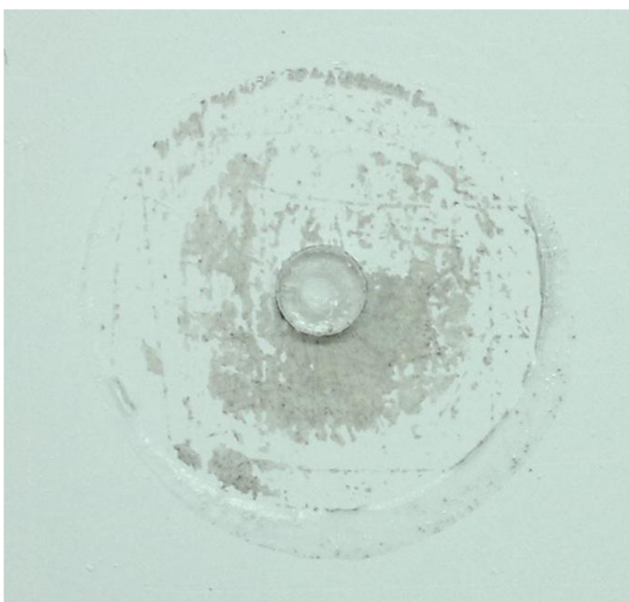
Obr. 53 Detail odtrhové zkoušky
