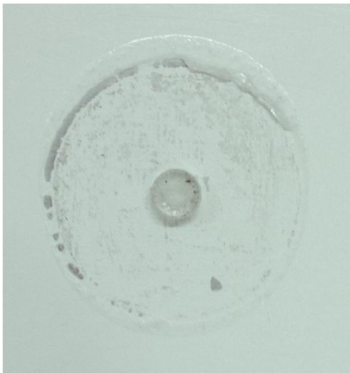
Obr. 52 Detail odtrhové zkoušky
