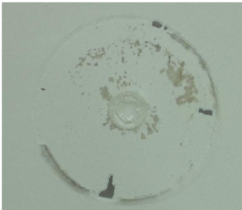
Obr. 54 Detail odtrhové zkoušky
