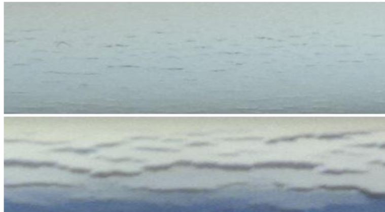
Obr.56 Rozdíl mezi lehkou a velkou prasklinou
