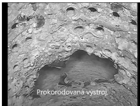
Obrázek 9 - Poškození výstroje vrtu Ř2 (VODNÍ ZDROJE a.s., 2019)
