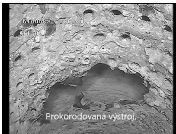
Obrázek 9 - Poškození výstroje vrtu Ř2 (VODNÍ ZDROJE a.s., 2019)
