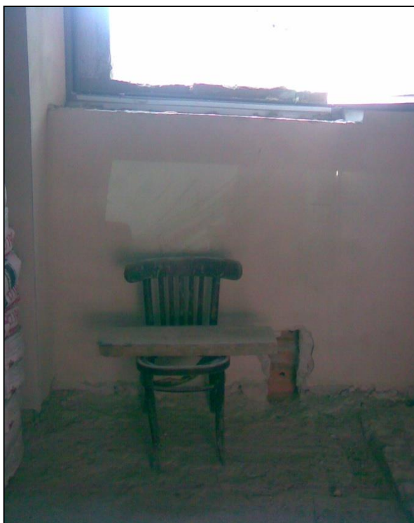
Obr. 6-10: Nevhodná konstrukce výlezu
