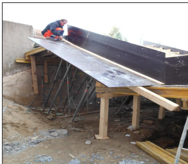
Obr. 6-17: Špatné zajištění proti pádu
