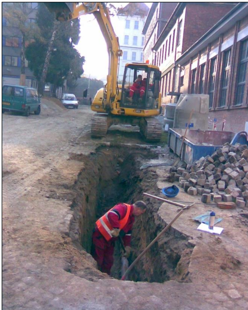
Obr. 6-4: Špatné zajištění výkopu
