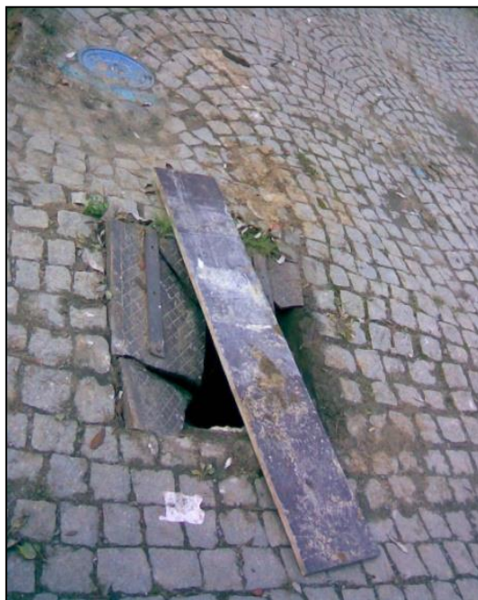
Obr. 6-13: Poškozený poklop kanalizace
