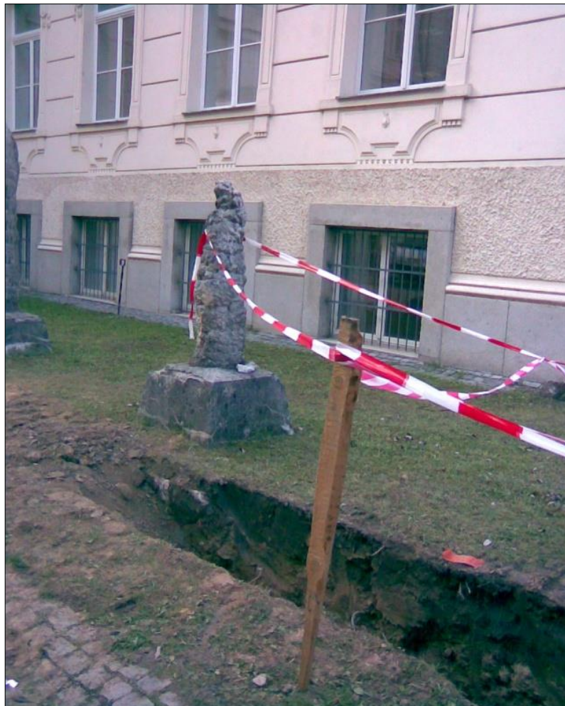
Obr. 6-2: Špatné zajištění kanalizace
