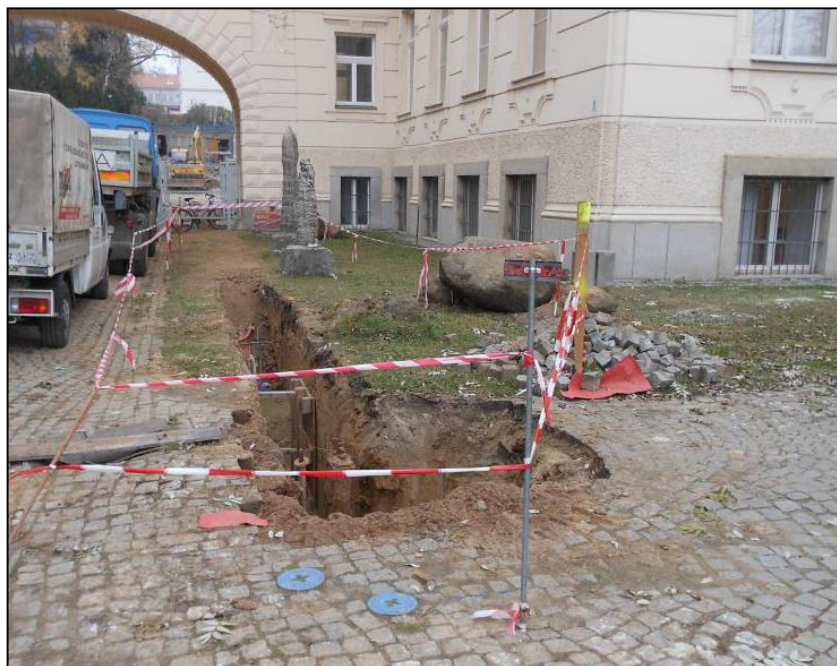
Obr. 6-12: Nedostatečné zábradlí výkopu
