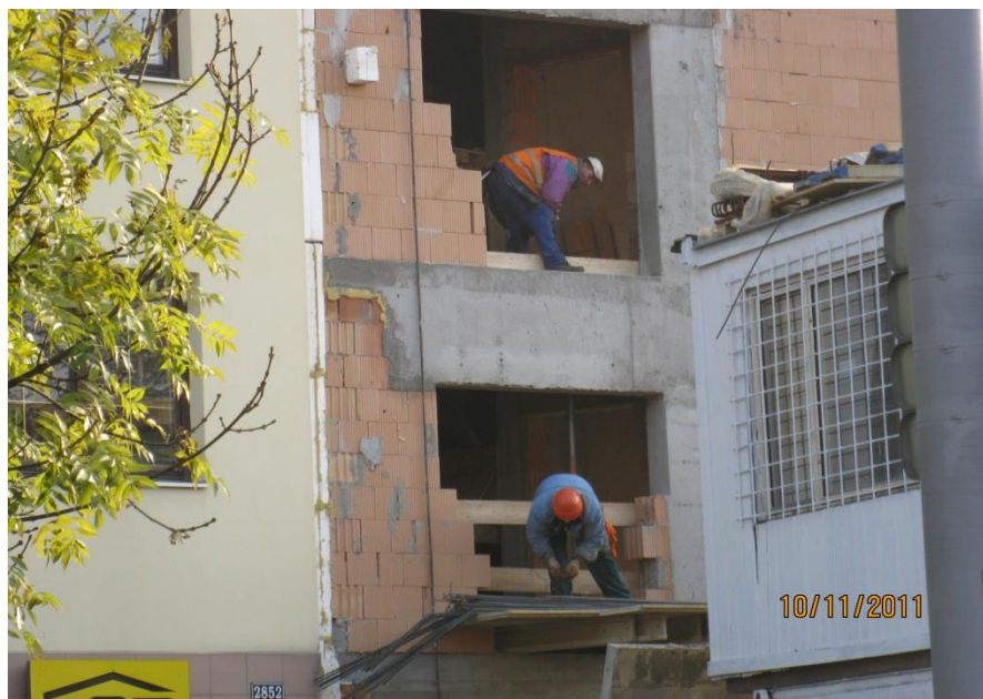
Obr. 6-22: Špatné zajištění proti pádu
