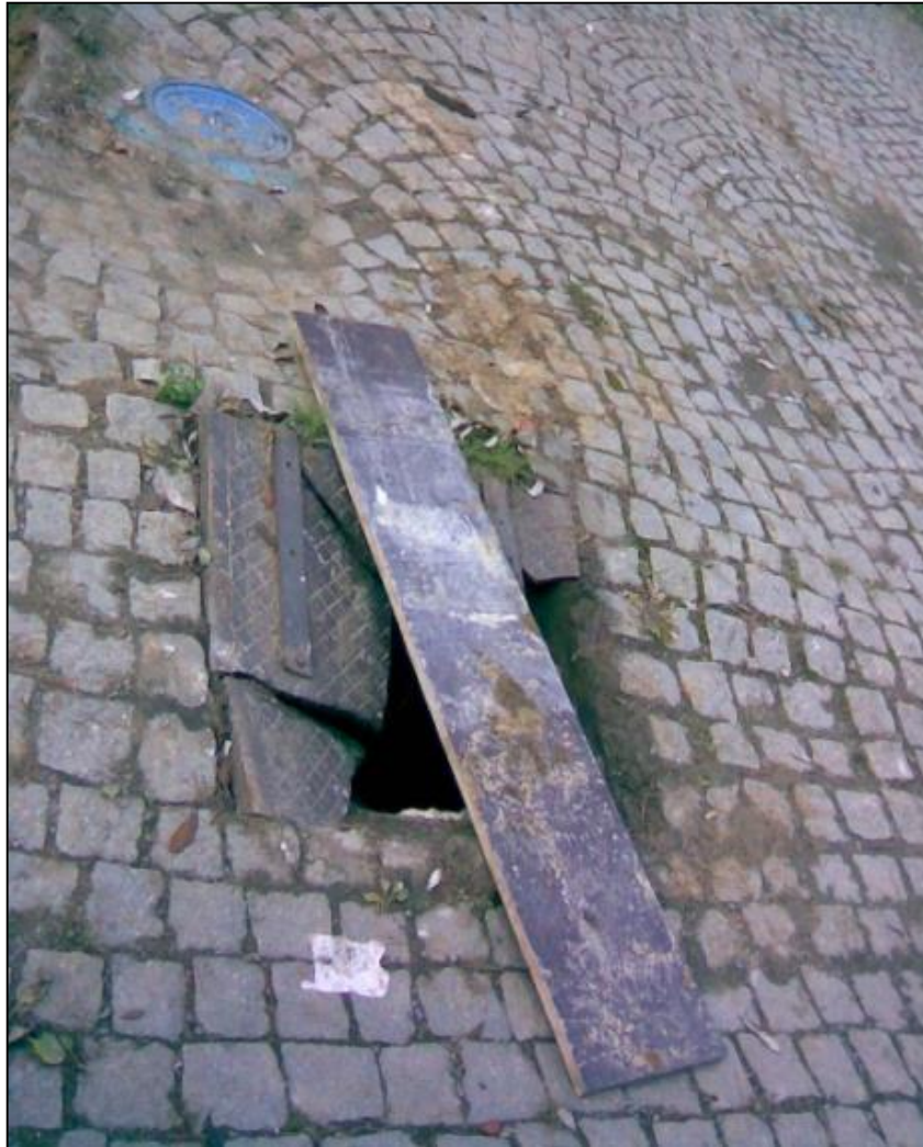
Obr. 6-3: Poškozený otvor kanalizace
