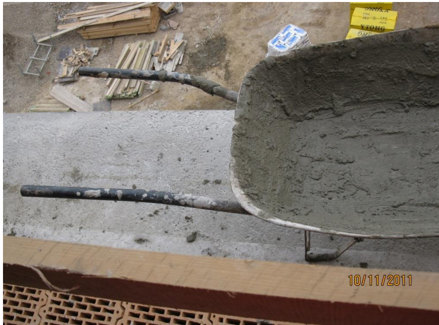
Obr. 6-20: Špatné zajištění náradí proti pádu
