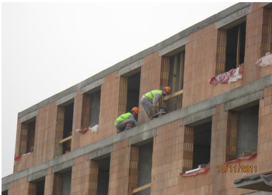
Obr. 6-18: Žádné zajištění proti pádu
