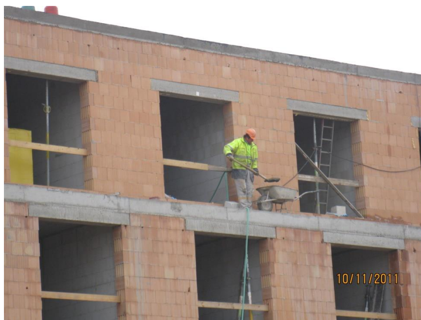
Obr. 6-19: Špatné zajištění proti pádu
