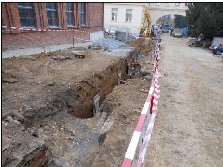
Obr. 6-14: Chybějící pažení výkopu
