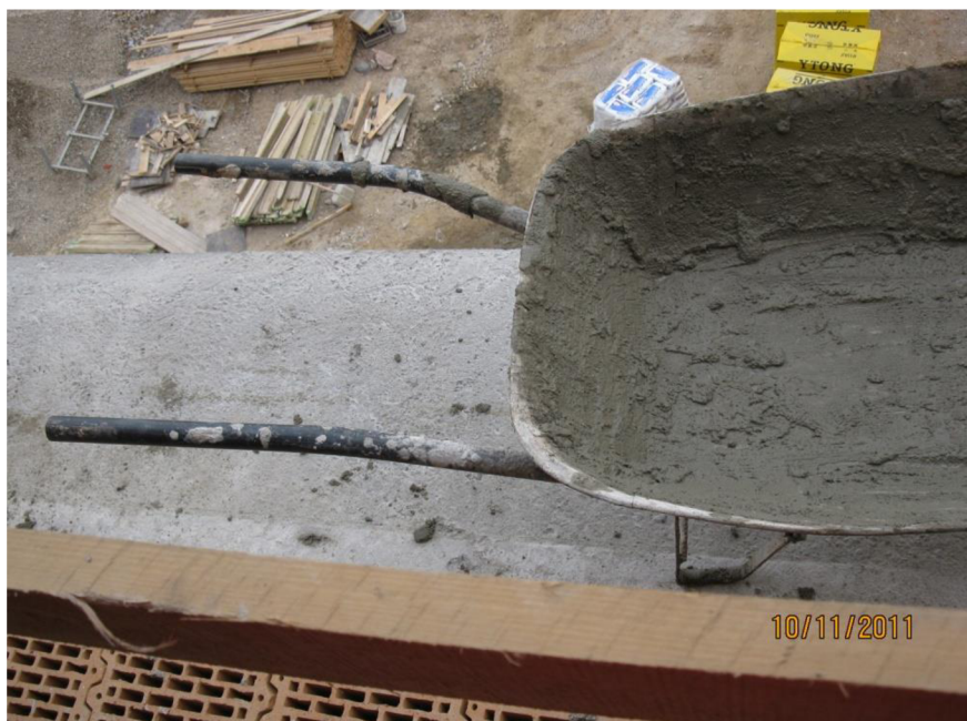
Obr. 6-20: Špatné zajištění náradí proti pádu
