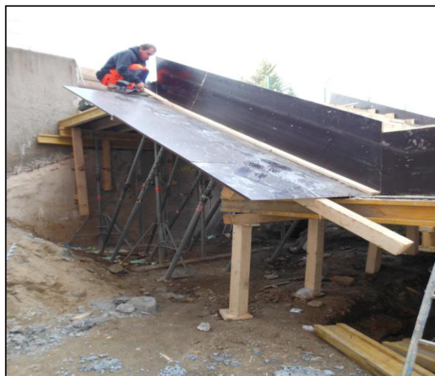
Obr. 6-17: Špatné zajištění proti pádu
