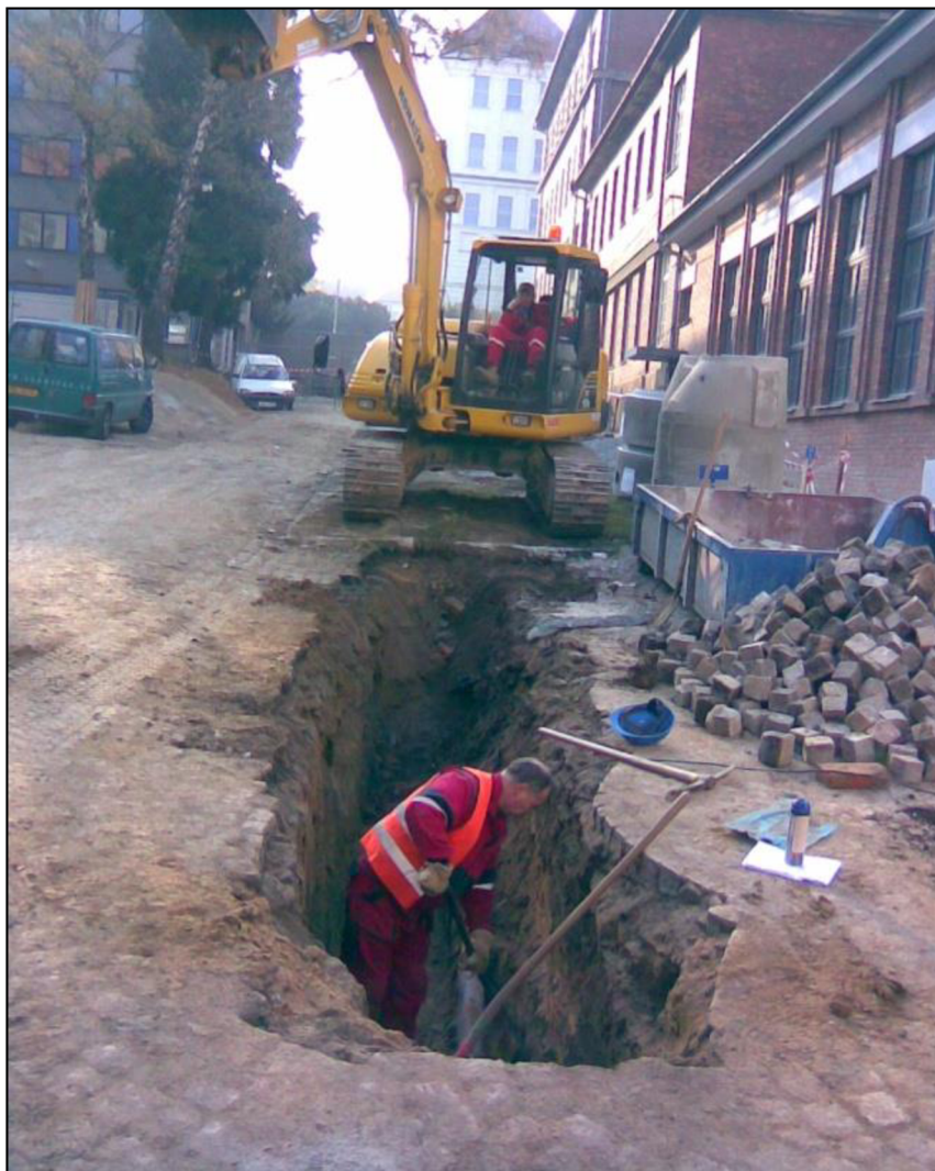
Obr. 6-4: Špatné zajištění výkopu
