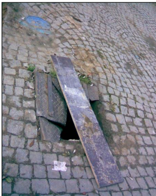
Obr. 6-13: Poškozený poklop kanalizace
