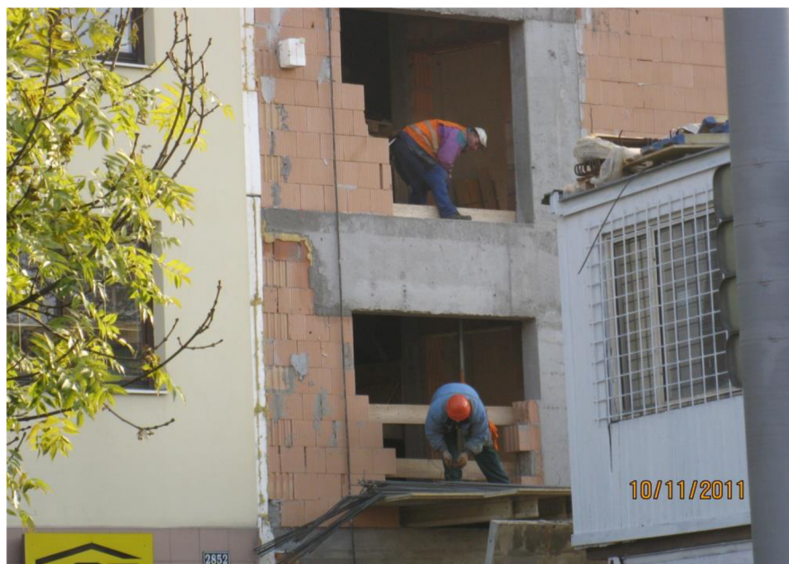
Obr. 6-22: Špatné zajištění proti pádu
