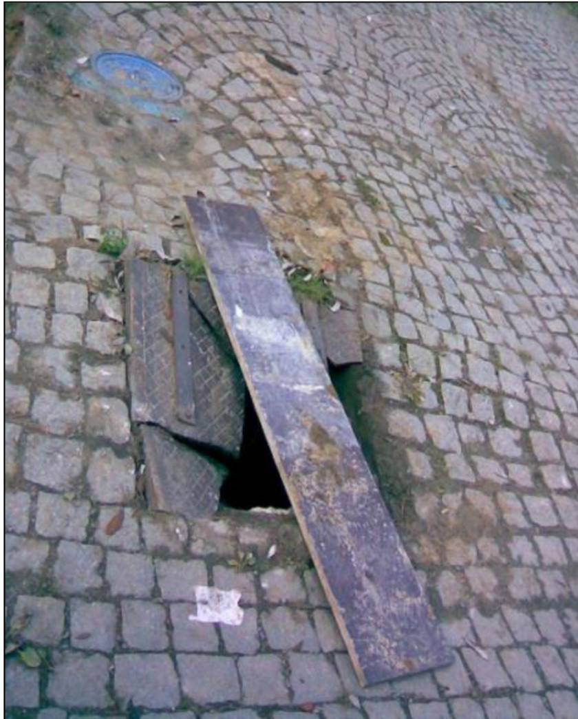
Obr. 6-3: Poškozený otvor kanalizace
