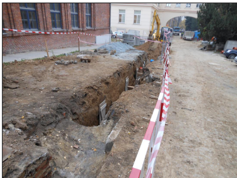
Obr. 6-14: Chybějící pažení výkopu
