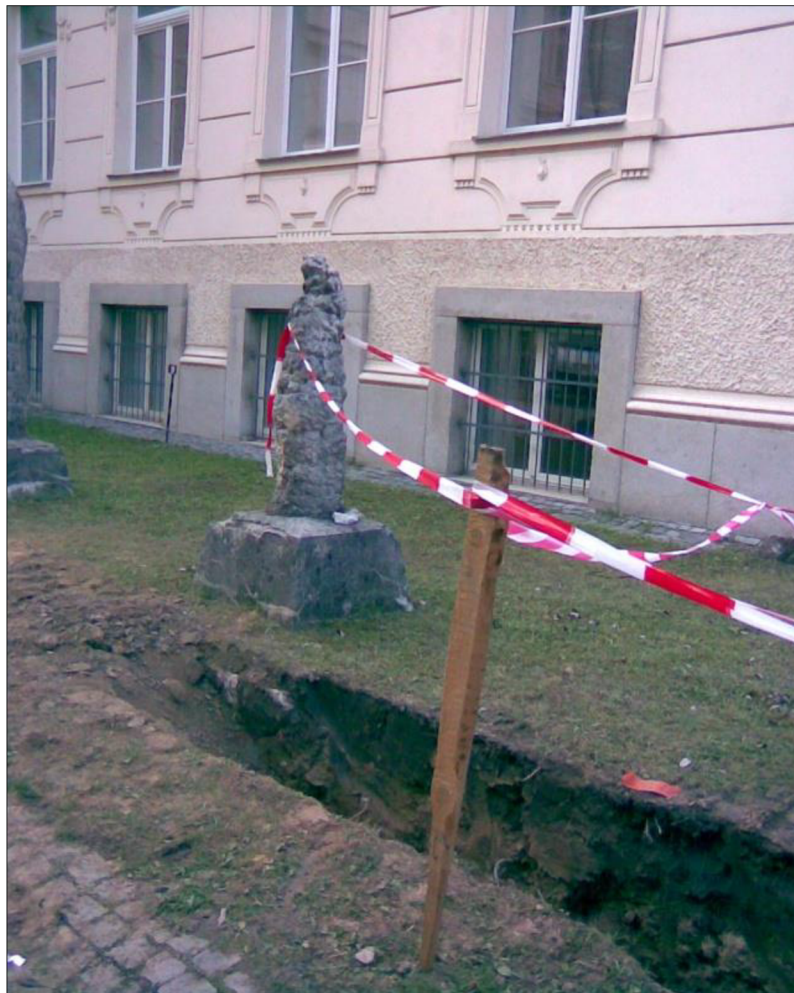
Obr. 6-2: Špatné zajištění kanalizace
