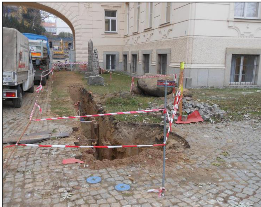
Obr. 6-12: Nedostatečné zábradlí výkopu
