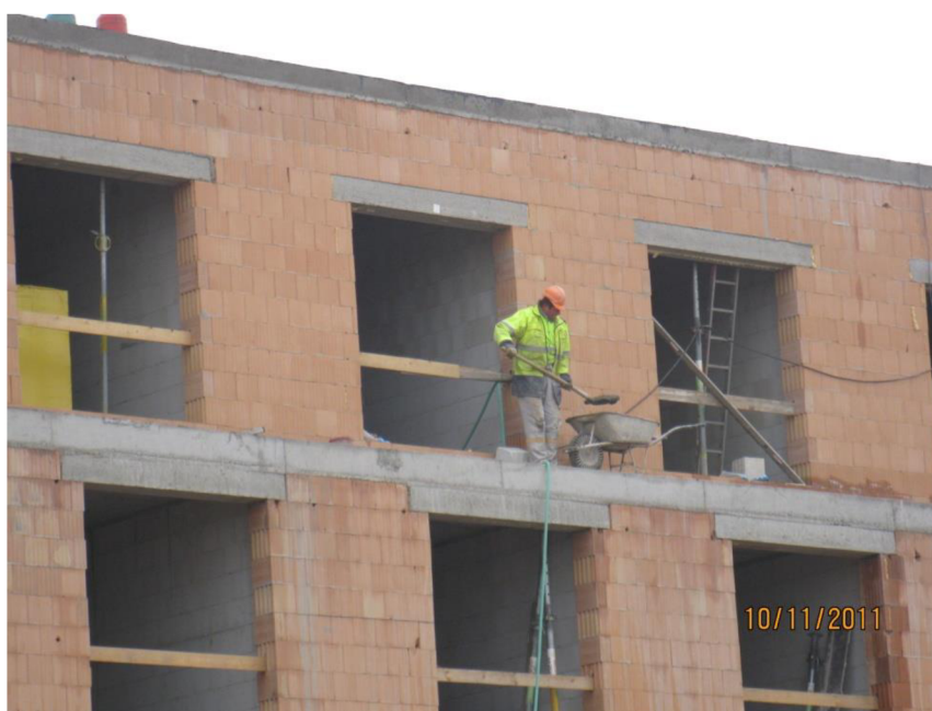
Obr. 6-19: Špatné zajištění proti pádu
