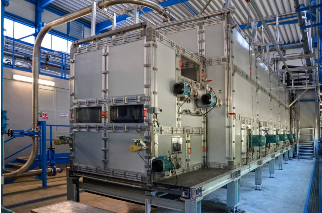
Obrázek 10 - Nízkoteplotní sušárna ČOV Karlovy Vary (Stavby Karlovarského kraje, 2020)
