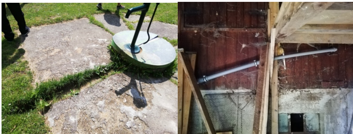
Obrázek 3 Ruční pumpa (vlevo), potrubí s odpadní vodou z kuchyně (vpravo) [zdroj: Krulová]
