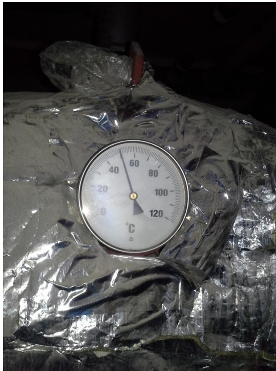
Foto 6. Teploměr na akumulční nádrži
