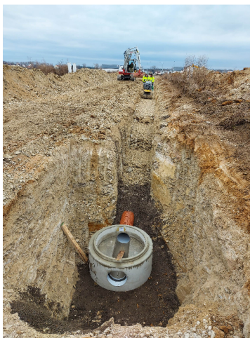
Obr. č. 11. Dešťová kanalizace (foto: autor, 2021)
