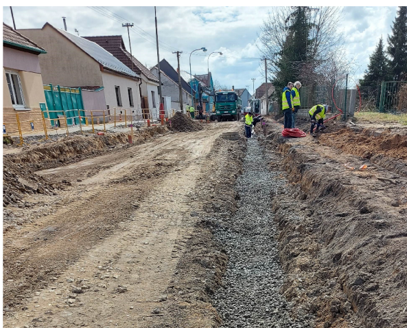
Obr. č. 12. Drenážní rýha (foto: autor, 2021)
