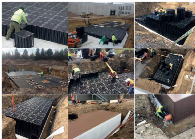
Obr. č. 16. Ukázka z realizace vsakovacích a retenčních objektů (MEA water management, 2021)
