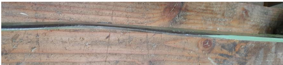
Obrázek 20: Deformace dělicích klínů
