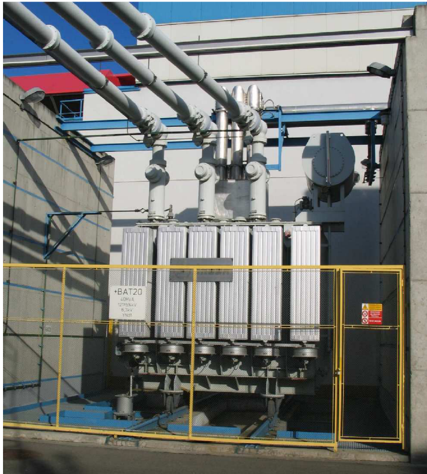
Obrázek 7.1 Transformátor MKA 20 - 40MVA, 121/6,3kV, Teplárny Brno a.s. - PČM
