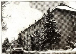
Stalingrad je nejstarší sídlištěm ve městě. První domy se tam stavěly před padesáti lety, některé v místech s vysokou hladinou spodní vody. Dnes do řady sklepů zatéká.
