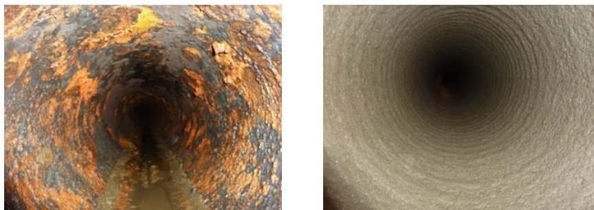
Obr. 11 – Cementace potrubí DN 500 řad II SVH – stav před sanací a po sanací 26
