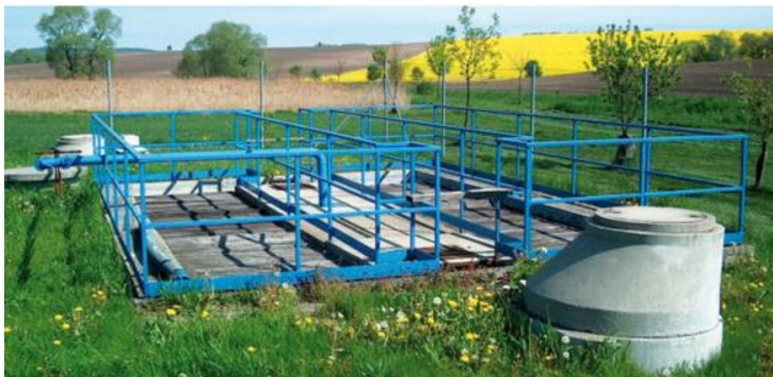
Obrázek 12: Štěrbínová usazovací nádrž komunální kořenové čistírny ( https://www.vtei.cz/en/2015/12/quality-of-sludges-and-wastes-from-household-and-small-wastewater-treatment-plants-and-their-utilization-in-agriculture-management/ ).
