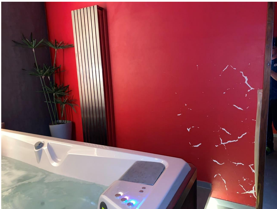
Obrázek 6 - Nevymalovaná část zdi, privátní vírivka Zdroj: vlastní zpracování
