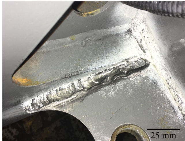
Obr. 3.1: Přímá vizuální kontrola svaru nosného dílu jeřábu po nehodě – dle VT je svar nepřijatelný.
