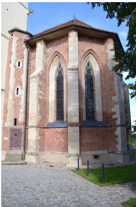
Obr. 36 – Exteriér pozdně gotického presbytáře kostela sv. Markéty v Loděnicích u Moravského Krumlova s cihlovou fasádou a lomenými okny mezi opěráky.
