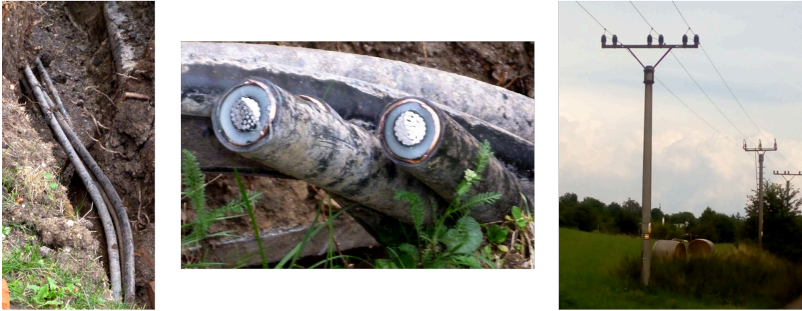
Obr. 10.5: Fotografie vedení vysokého napětí - uložení kabelů v zemi, průřez kabelů, nadzemní vedení
