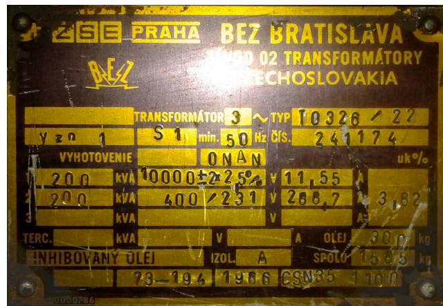
Obr. 6.1: Štítek měřeného transformátoru s detailními informacemi o něm
