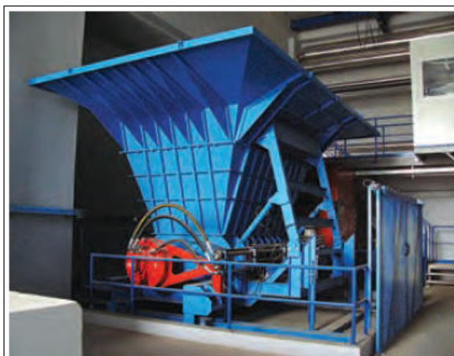
Obr. č. 3.3: Drtící zařízení ve spalovně SAKO, a.s., zdroj: [24]
