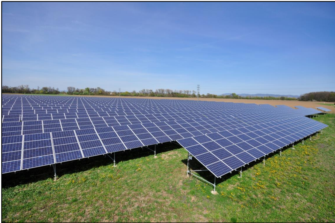
Obr. 6: Panely sluneční elektrárny v Kroměříži (Fotovoltaika.nwt, 2019)
