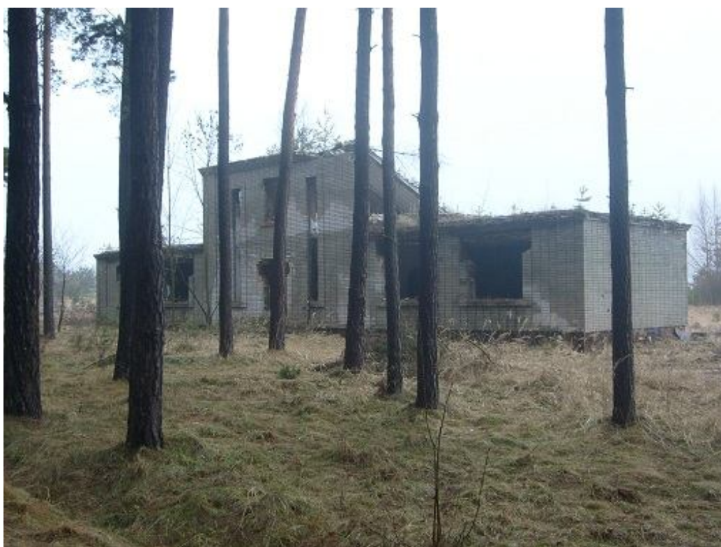
FOTO 12: Chátrající budova v části Vrchbělá
