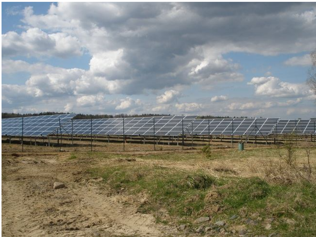
FOTO 14: Fotovoltaická elektrárna v Kuřívodech (vedle silnice směrem na Bělou pod Bezdězem)
