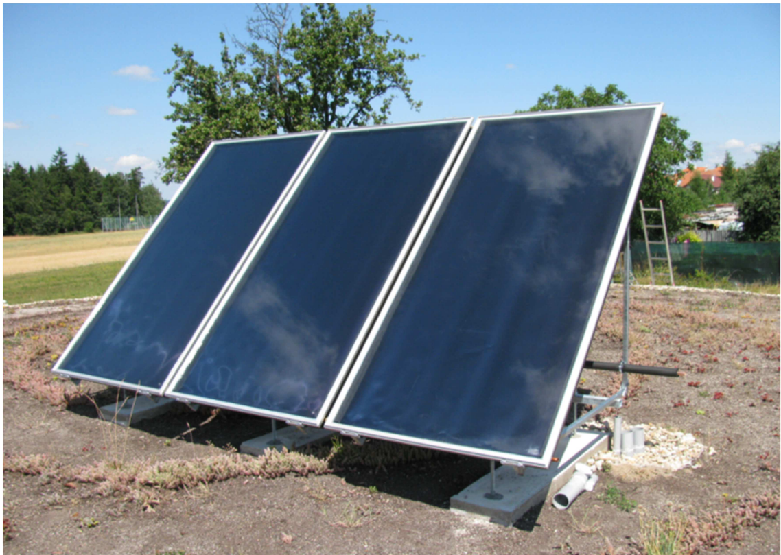
Obr. 50 - Solární termické kolektory SK 218 Freesun (foto autora)
