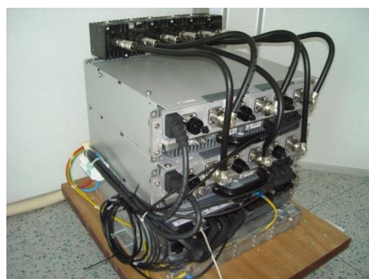
Obrázek 24 Nokia Siemens Network Flexi BTS LTE – Test Lab O2 Czech republic [18]
