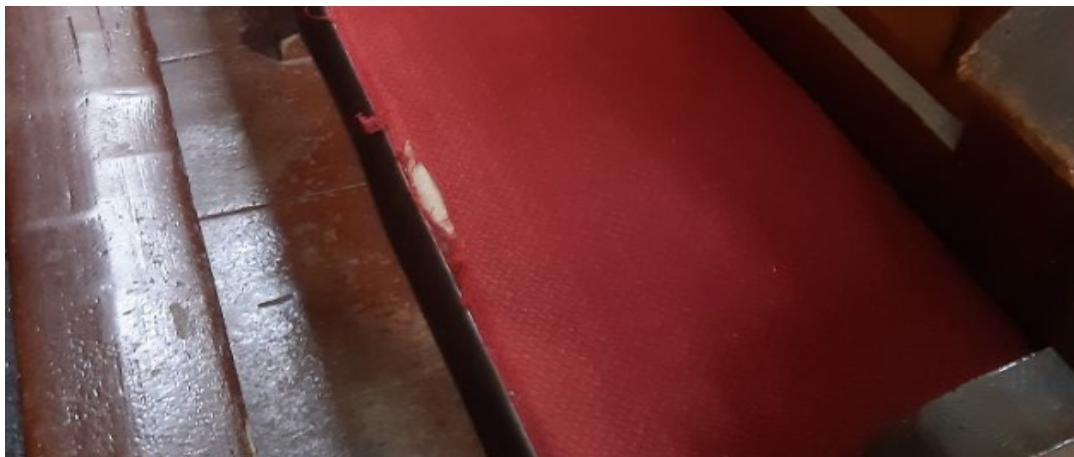
Obrázek č. 3 – poškození lavic
