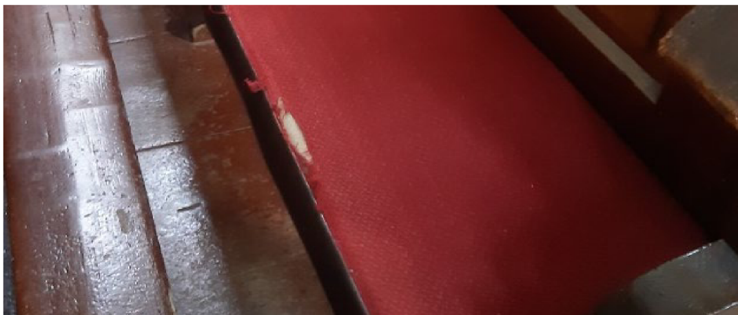
Obrázek č. 3 – poškození lavic
