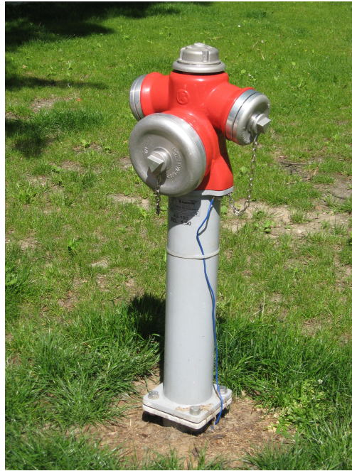
Foto 11 ó Vn j-í nadzemní pofární hydrant
