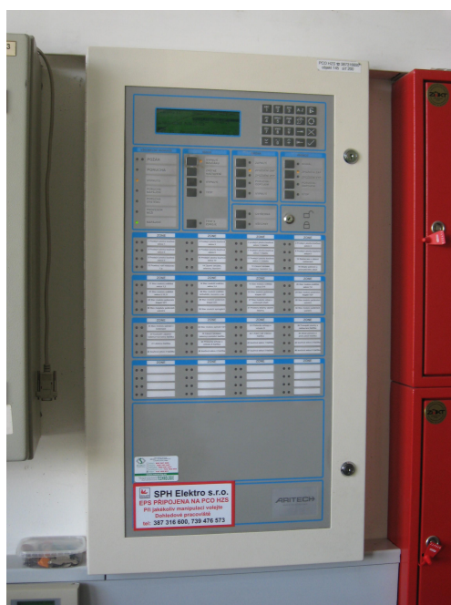
Foto 3 ó Úst edna za ízení elektrické požární signalizace
