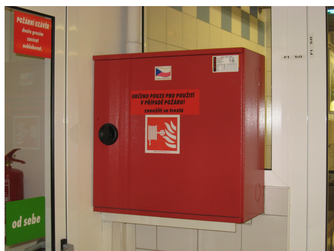
Foto 10 o Vnit ní nást nný pofární hydrant
