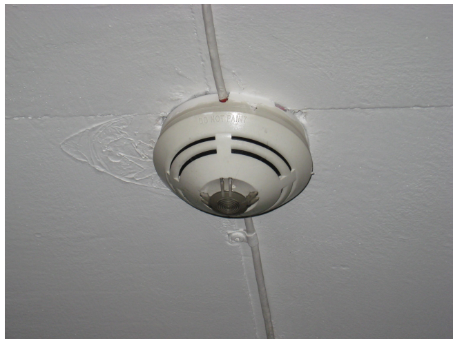
Foto 1 ó Hlási pofláru za ízení elektrické poflární signalizace
