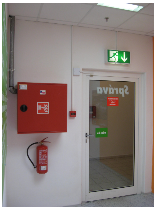
Foto 9 o Pofární uzáv r, vnit ní nást nný pofární hydrant, p enosný hasicí p ístroj, nouzové osv tlení
