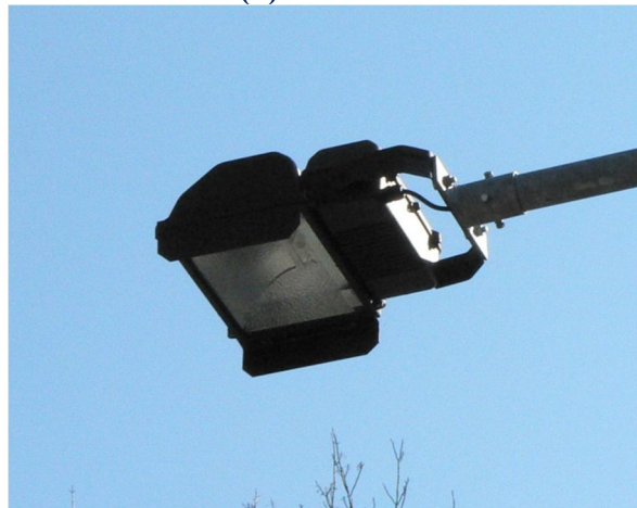
(2) Ulice Lidická (49.5555444N, 17.2517700E) Osvětlení přechodu pro chodce, účelně využívané 100 % světla, zastíněné
