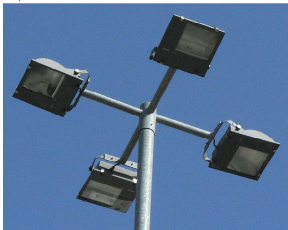
(5) Ulice Holická (49.5820753N, 17.2714481E) Osvětlení parkoviště, vhodně směřované, plochý difuzor
