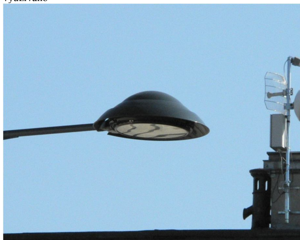
(9) Ulice Na střelnici (49.5989672N, 17.2513061E) Nejvhodnější svítidlo – plochý difuzor, který směřuje nepříliš jasné světlo rovnou pod sebe Zdroj: Autor
