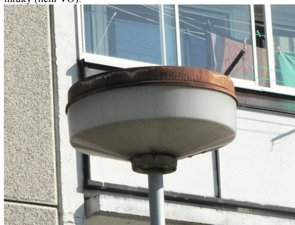
(10) Ulice Kaštanová (49.5983083N, 17.2716694E) Svítidlo 446 05 15 / 446 05 70 je zastaralé, svítí ze 40 % do oken panelového bytu
