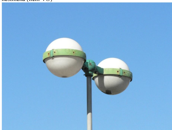
(11) Ulice Pasteurova (49.5989122N, 17.2722925E) Svítidlo 446 16 01 / 446 19 01; 50 % světla je vyzařováno do horního poloprostoru, využitelná je pouze cca 1/5 světelného výkonu Zdroj: Autor
