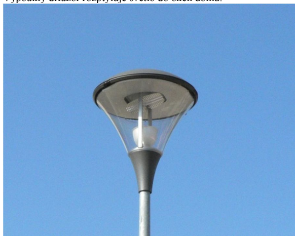
(3) Ulice Kozušanská (49.5538911N, 17.2488939E) Zajímavé konstrukční řešení, nastavitelná odrazivá plocha, ale svítí do oken domů
