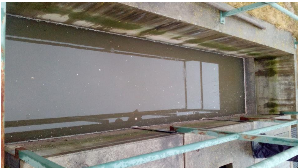
Obr. 13 Kořenová čistírna C: Štěrbinová nádrž
