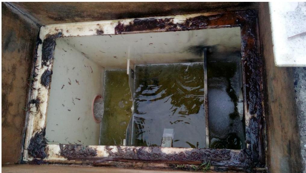
Obr. 15 Kořenová čistírna C: Měrná šachta
