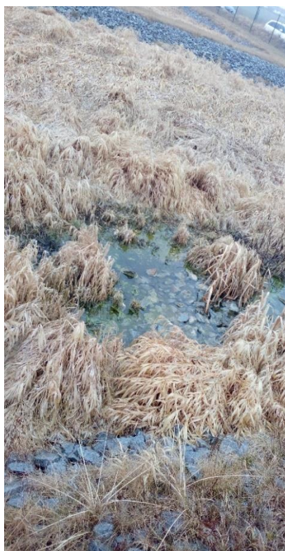
Obr. 5 Kořenová čistírna C: Zaplavená část filtračního lože
