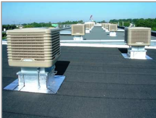
Obr. 17: Decentralizované větrání haly z vnějšího pohledu [50]
