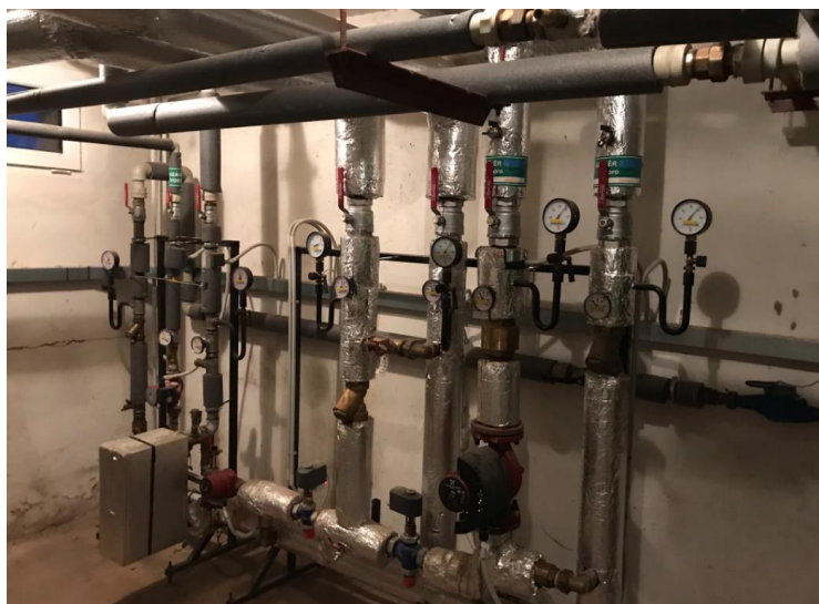
Obrázek 28 - Předávací stanice v bytovém domě (autor)
