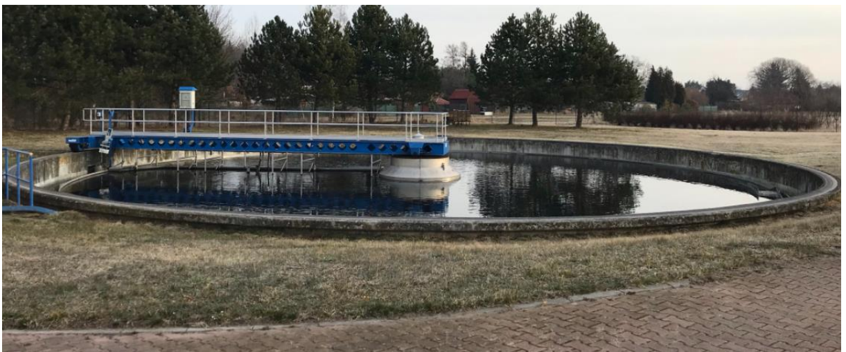
Obrázek 10 - Dosazovací nádrž ČOV Kolín (autor)
