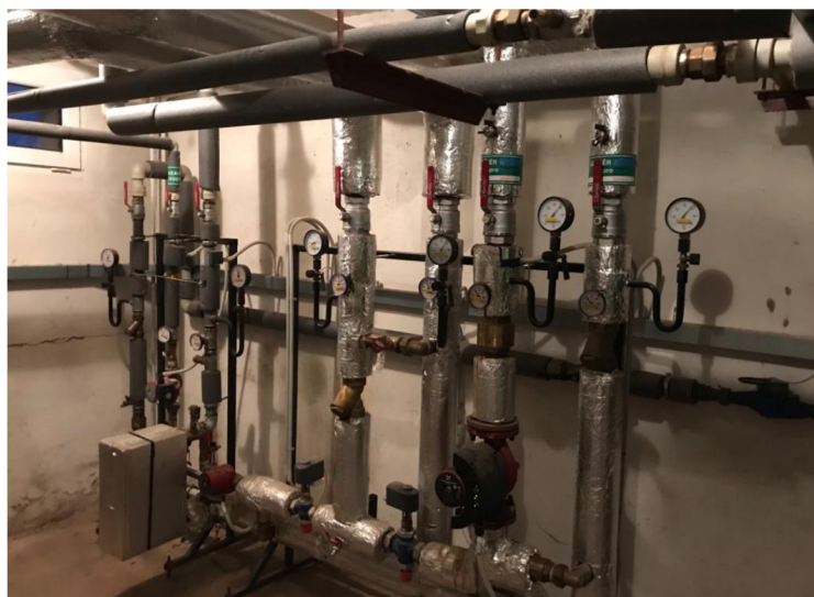
Obrázek 28 - Předávací stanice v bytovém domě (autor)
