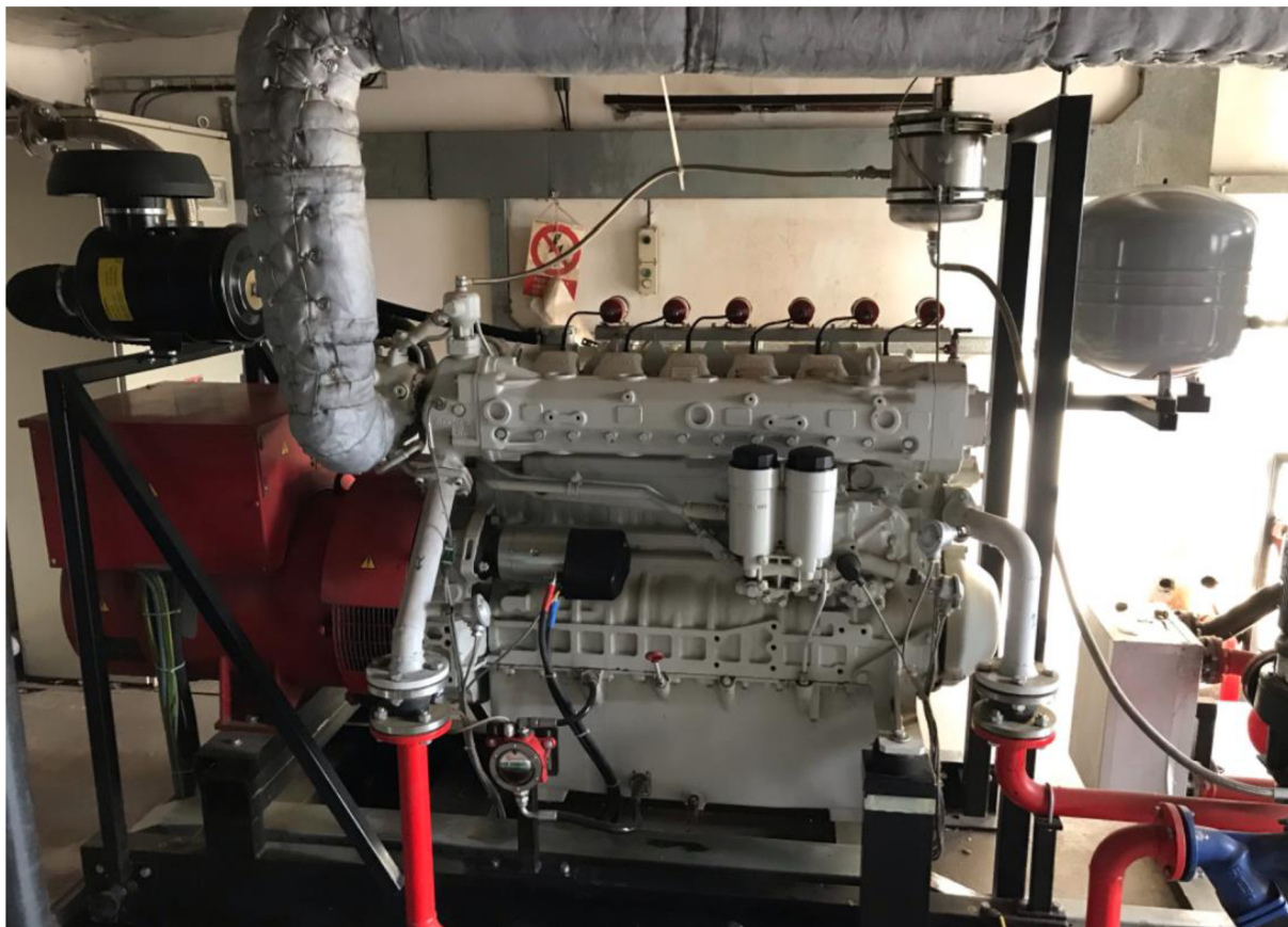
Obrázek 21 - Kogenerační jednotka na ČOV Kolín (autor)
