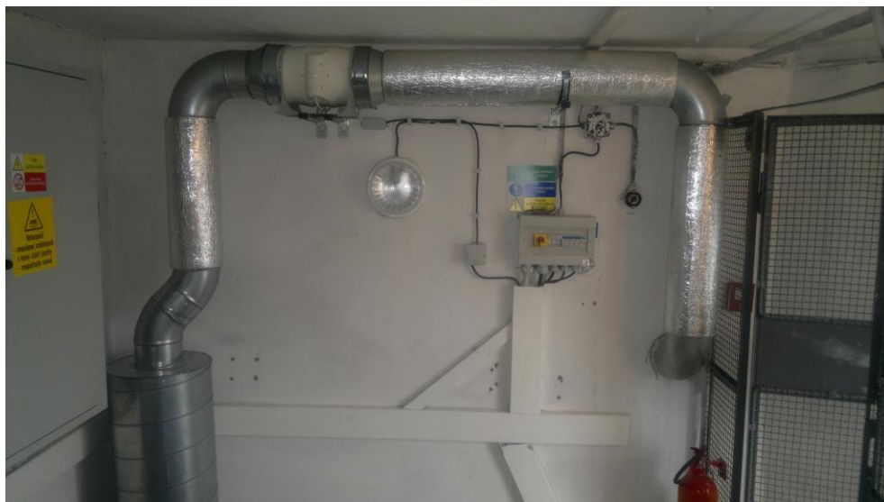
Obrázek 9 - Strojovna výtahu (Zdroj: vlastní)
