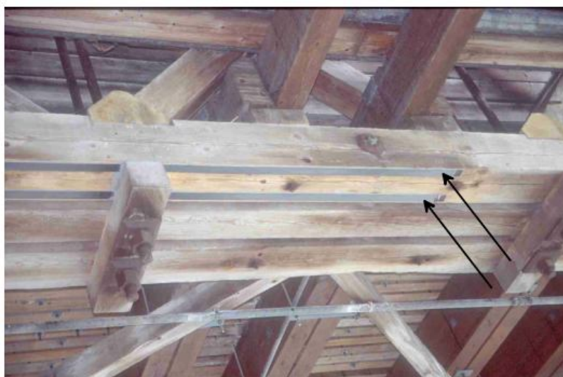
Obr.č. 25: Dodatečné vyztužení prvku na spodní ploše-most v městě Murgenthal na řece Aare (Švýcarsko)
