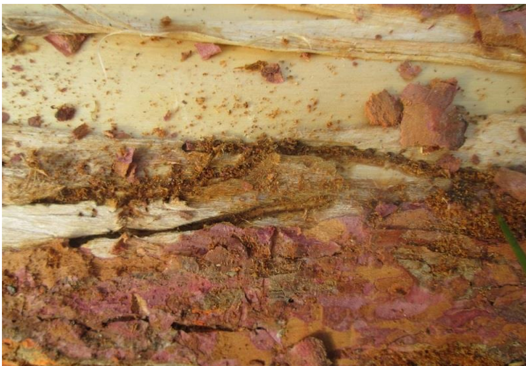
Obr. č. 5: Detail požerku lýkožrouta modřínového
