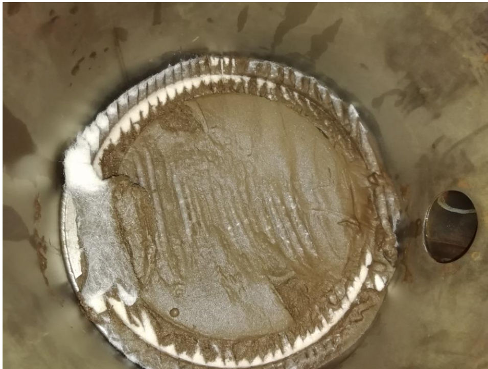
Obrázek 33: Zanesený skládaný filtr VFT 4/P
