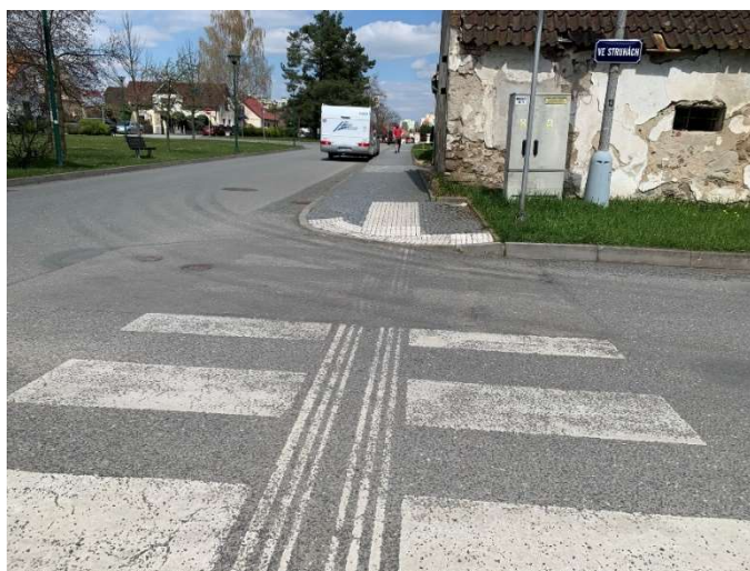
Obrázek 8.6 – Špatně provedená hmatová úprava v ul. Ve Struhách
