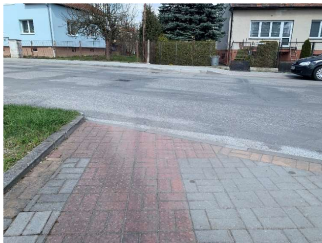
Obrázek 8.5 – Špatně provedená hmatová úprava v ul. Jaroslava Vacka
