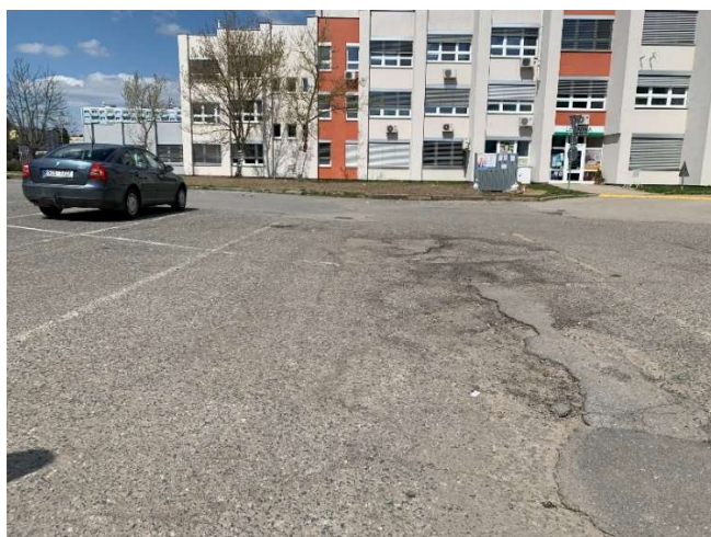
Obrázek 31 - Špatný technický stav povrchu parkoviště u nemocnice, včetně špatného stavu VDZ
