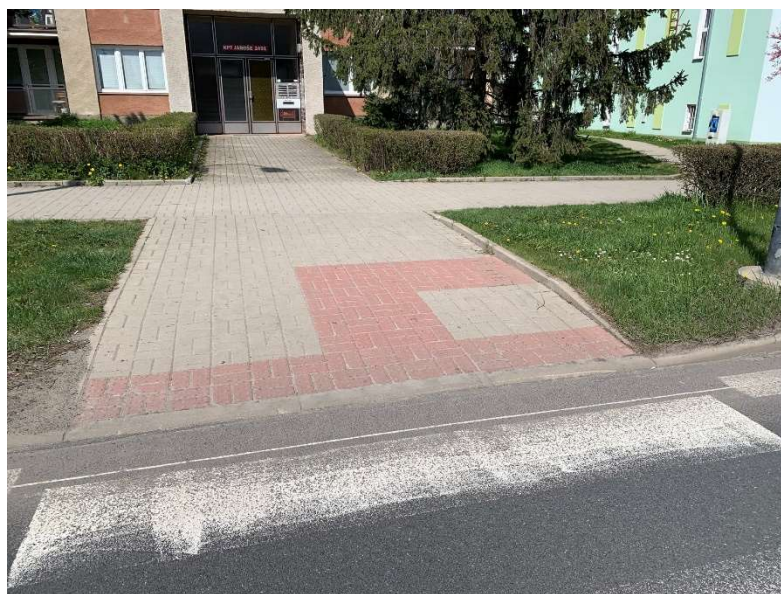
Obrázek 8.7 – Špatně provedená hmatová úprava v ul. Kpt. Jaroše
