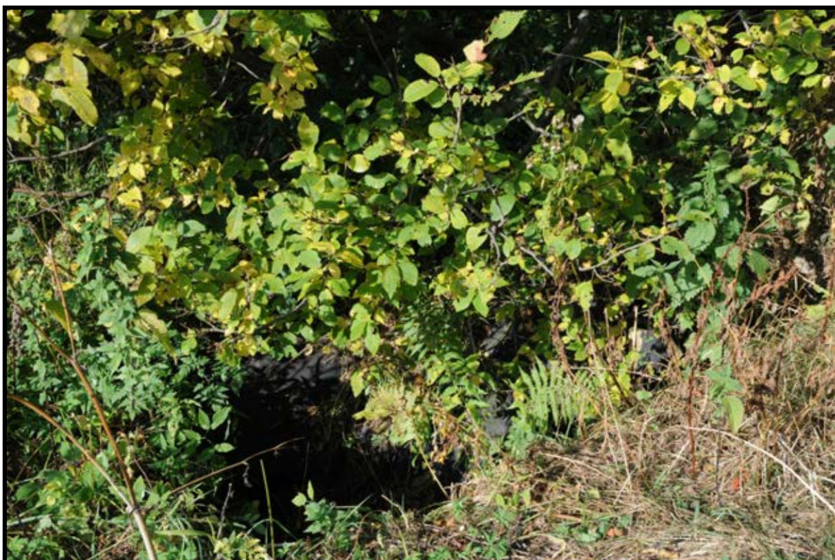
Obr. č. 29 Propadlý poklop septiku na Rennerových boudách (25.9.2015, autor: M. Skalický)
