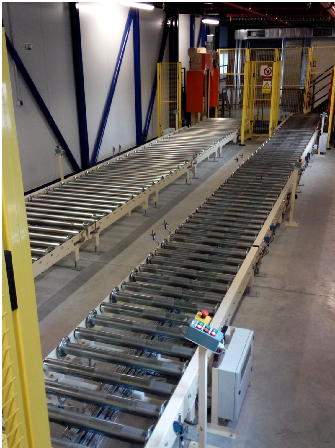
Příloha č. 8: Pohled na válečkové dopravníky ve vnitřním prostoru krčku
