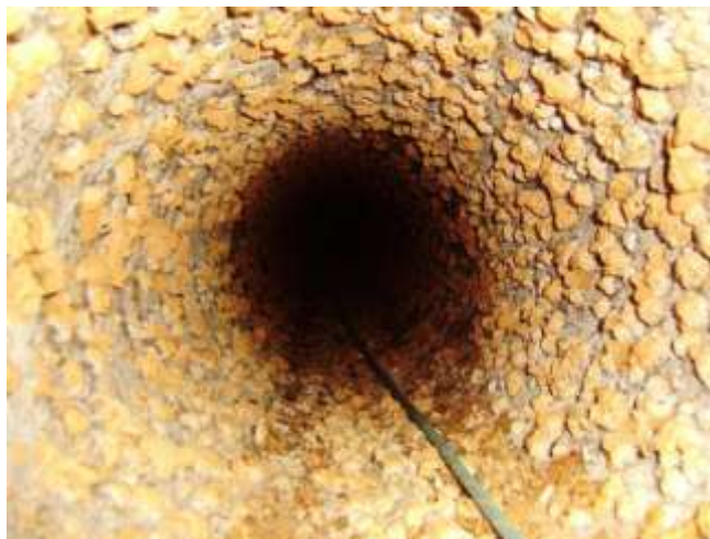
Obr. č. 30: Vodovodní přivaděč Tanvald –Krásná před Cementací (© Šedová)
