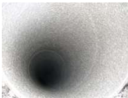
Obr. č. 25: Pohled do vycementovaného potrubí, Tanvald (©Šedová)
