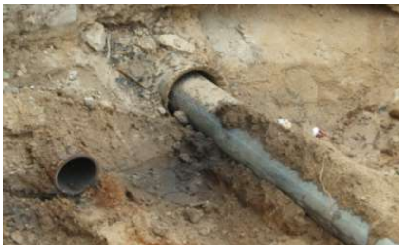
Obr.č.8: Zatažené PE potrubí d 315 mm do stávajícího ocelového řadu DN 400 mm, Mělník
