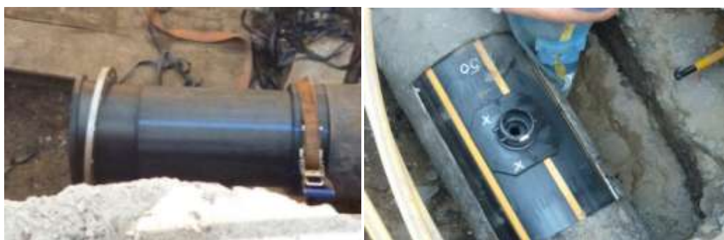
Obr.č. 14: Propoj s armaturou pomocí lemového nákržku, Obr. č. 15: Vysazení odbočky pomocí elektrotvarovky (© Maiová 2011)
