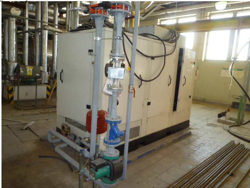
Obrázek č.5: Kogenerační jednotka
