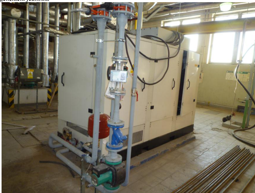
Obrázek č.5: Kogenerační jednotka
