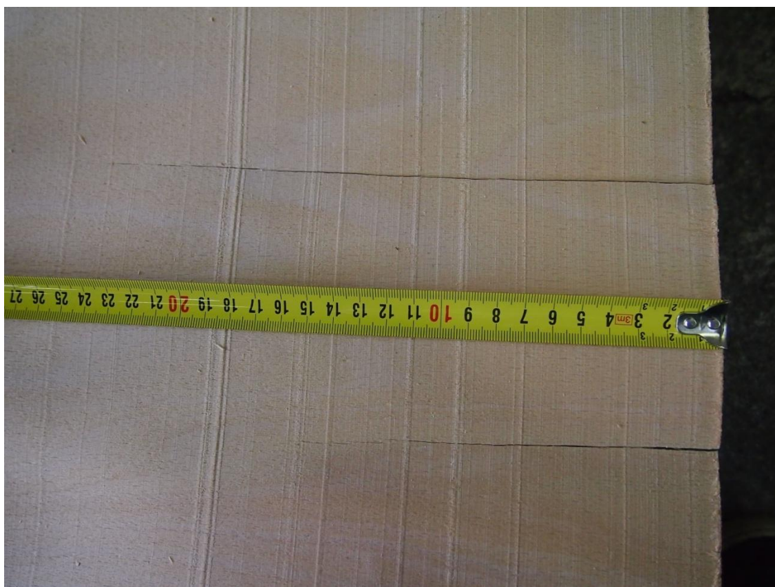
Obr. 22.; Trhliny o délce 23 a 12 cm
