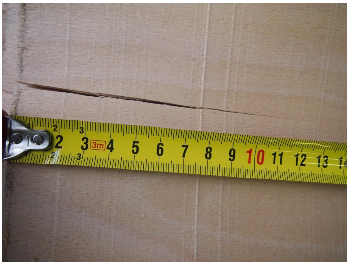
Obr. 15.; Trhlina o délce 11 cm
