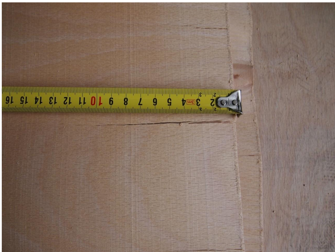
Obr. 23.; Trhlina o délce 11 cm
