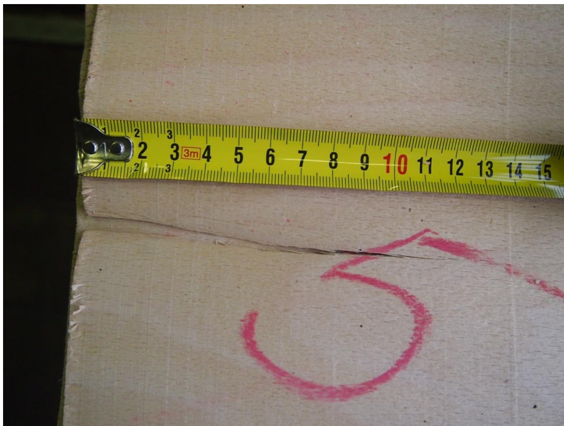
Obr. 16.; Trhlina o délce 12 cm
