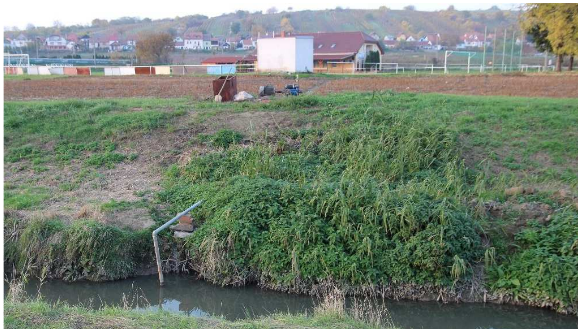
Obr. 3.11: Čerpadlo a sací potrubí čerpadla původní závlahy, objekt stávající elektrorozvodny v pozadí
