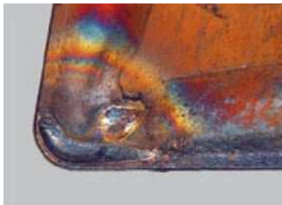
Obr. 19 Výmol na čele [10]
