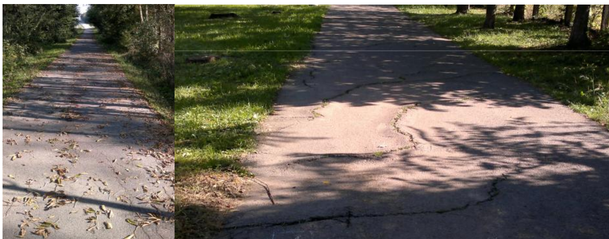
Obrázek . 13 – Problém pokryvu stezky listy a zhoršené kvality povrchu Zdroj: vlastní foto, dne 2. října 2013
