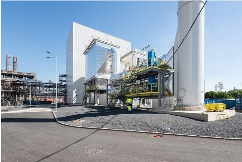
Obr. 4 – Teplárna vybavena plynovými kotli (zdroj: Unipetrol)
